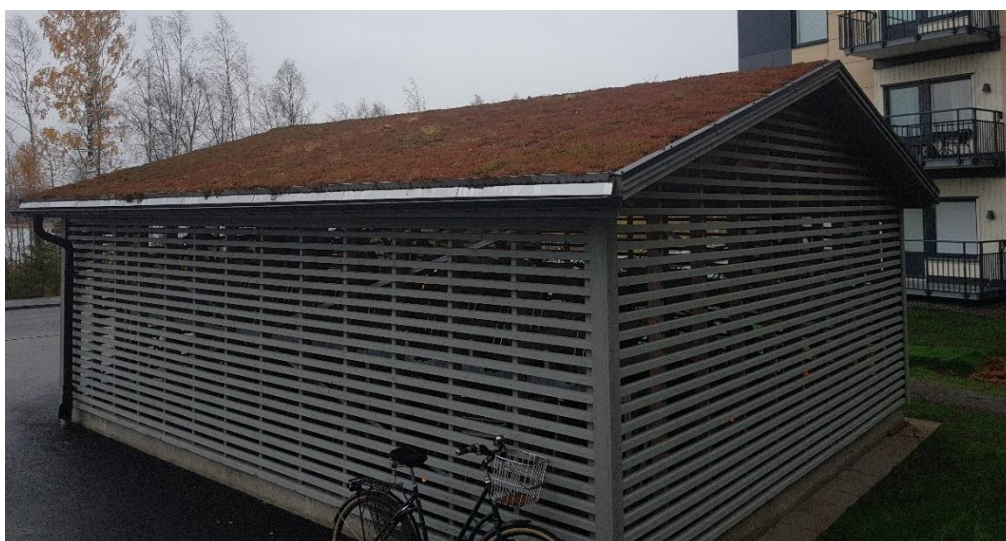
Figur 11. Gröna tak kan anläggas både på platta och lutande tak (Foto: AFRY).
